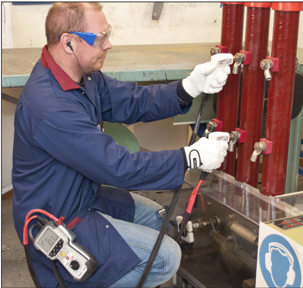
手持探头，将开尔文夹夹到断路器上，按下trig/TEST按钮。有一个信号指示测试通过或失败，测试结果被记录在仪器内，稍后可存储到电脑。
